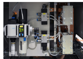
Stromschalter mit Pneumatikeinheit
